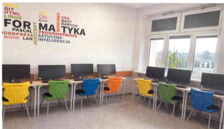
Fot. Remont pracowni komputerowej -Szkoła Podstawowa nr 3 im. Z. Herberta we Wronkach
