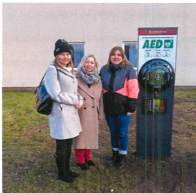
Fot. Stojak zewnętrzny na defibrylator mieszczący się przy budynku kręgielni
