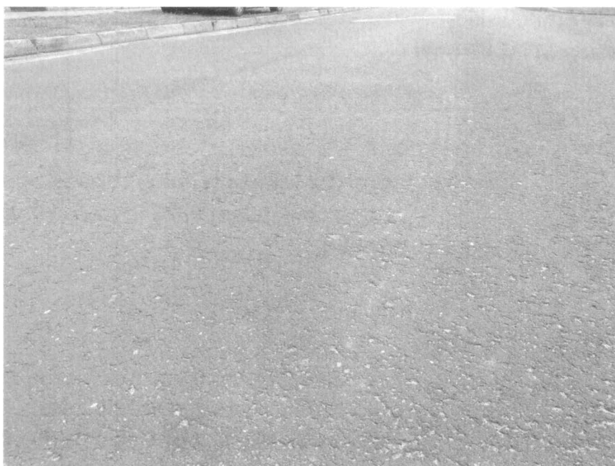
Wybrzuszenie nawierzchni ul. Topolowej.
